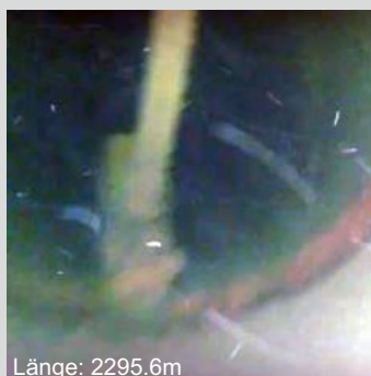
Inspektion Kraftwerksleitung - Fremdkörper Hammer
